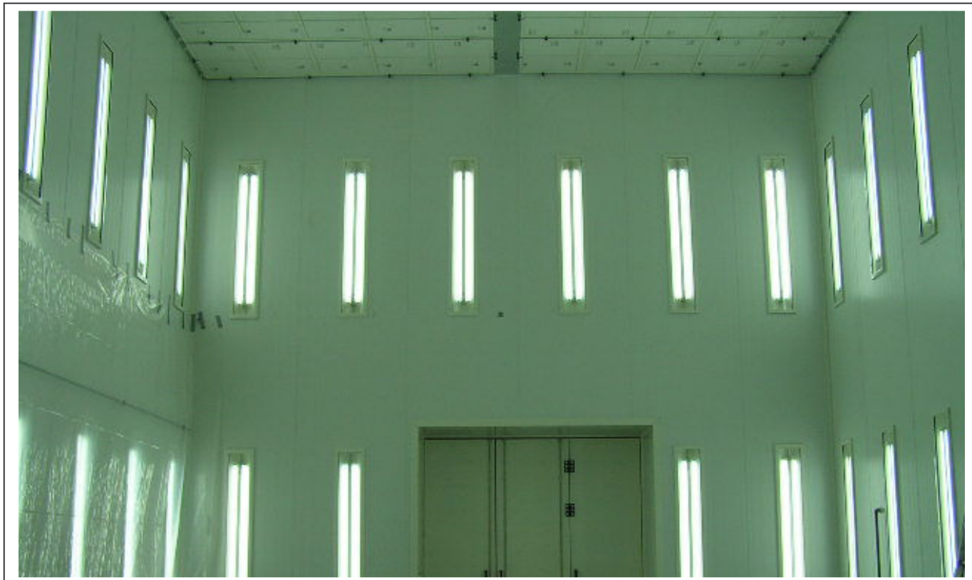
Sprøjte-/tørrekabine hos Aalborg Industries.
