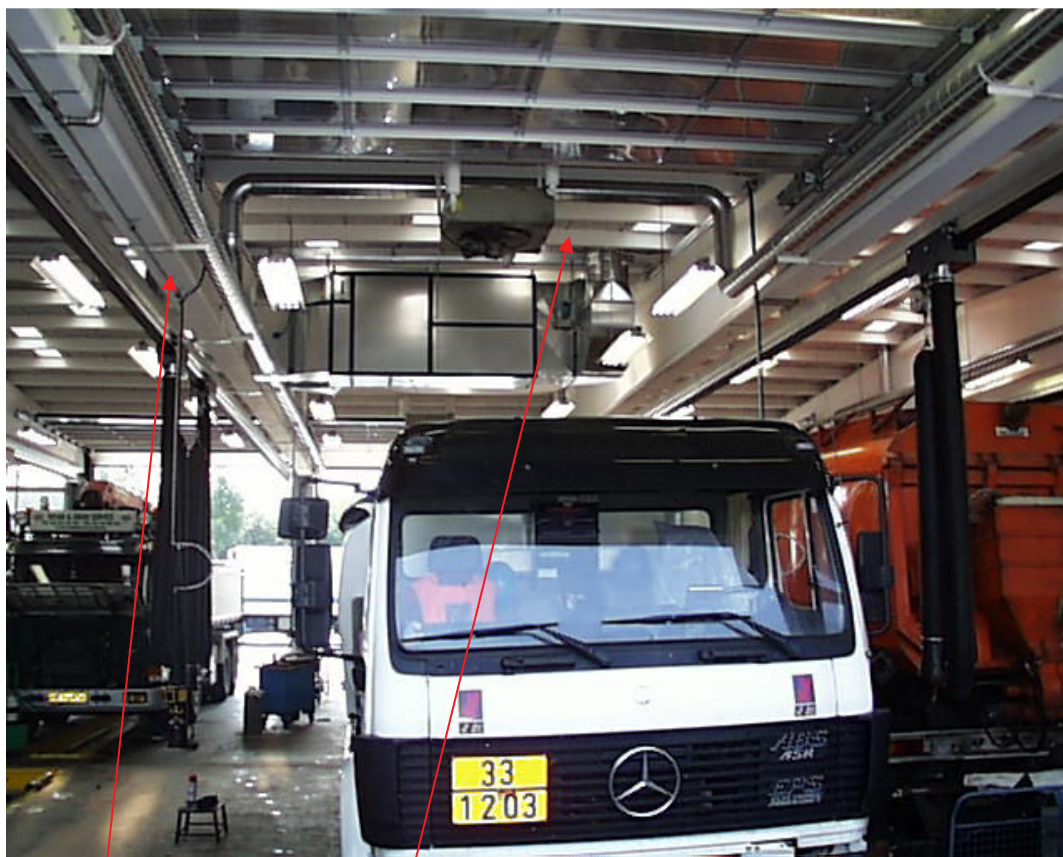
Rumventilation og røggasudsugningsanlæg
